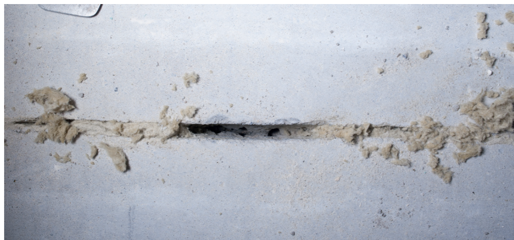
Abbildung 29: Montagefehler beim Bau des Teststandes: Schallbrücken durch nicht durchgängige Trennung der Estrichlagen zwischen den Räumen. Foto: Carina Bauer.
