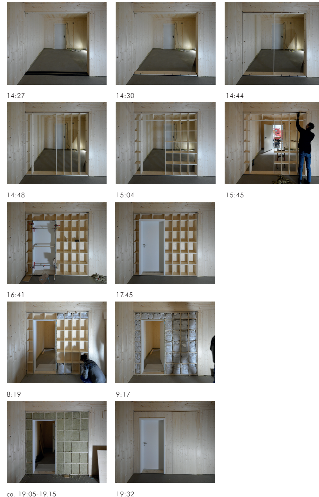
Abbildung 42: Aufbauschritte der Regalwand TW02 im Zeitablauf, Aufbauzeit im Versuch von 14:27 Uhr bis ca. 19:30 Uhr bis zur kompletten Fertigstellung im Eigenbau. Fotos: DGJ Architektur, 09.04.2019.
